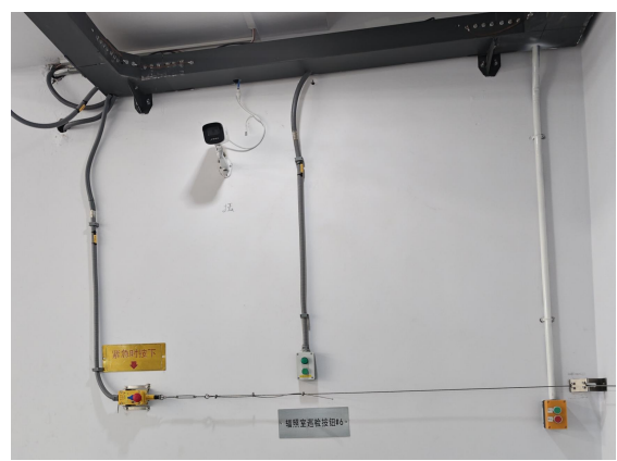
主机室内巡检按钮、紧急拉线开关
