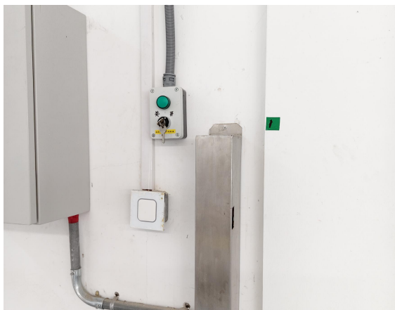
巡检钥匙开关
