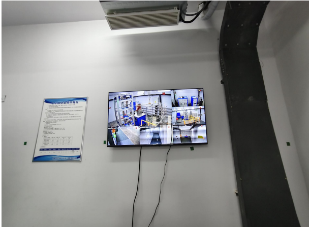
控制室监控显示屏
