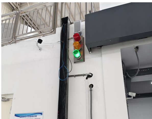
主机室外警灯、摄像头、音响
