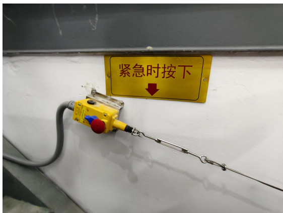
辐照室内紧急拉线开关
