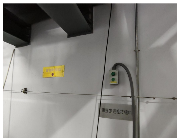
辐照室内巡检按钮
