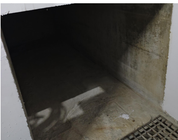
辐照室内排风口
