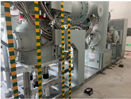
图 4-9 110kV 配电装置
