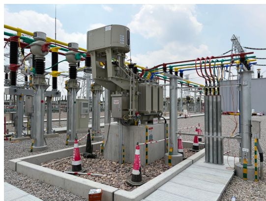
#2 站用变及贮油坑
