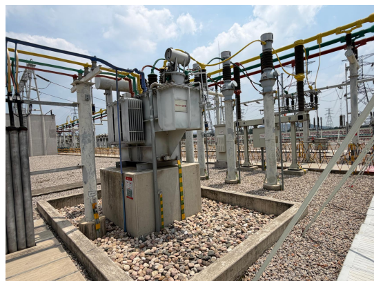
#1 站用变及贮油坑
