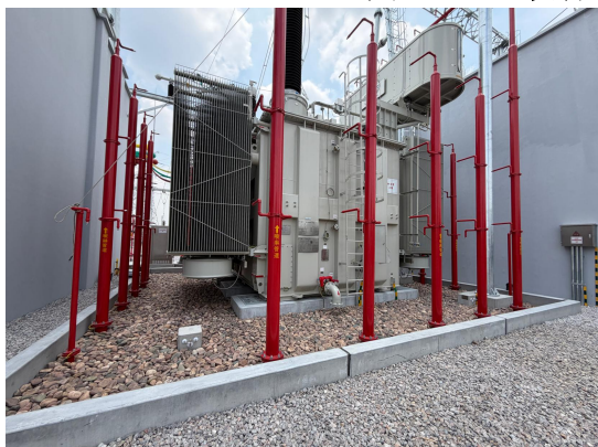
#4 主变（A 相）及贮油坑
