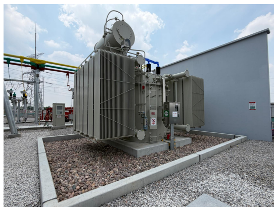
低压电抗器及贮油坑
