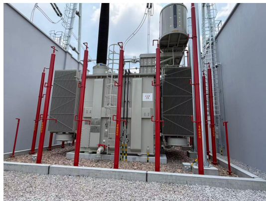
#4 主变（B 相）及贮油坑
