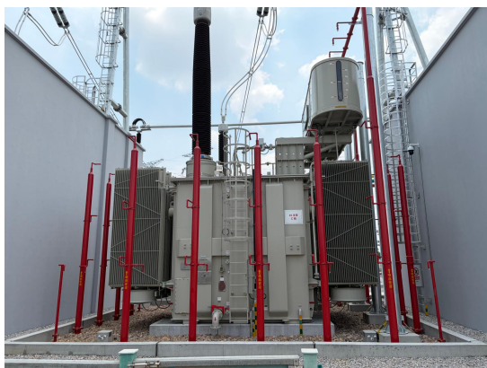
#4 主变（C 相）及贮油坑
