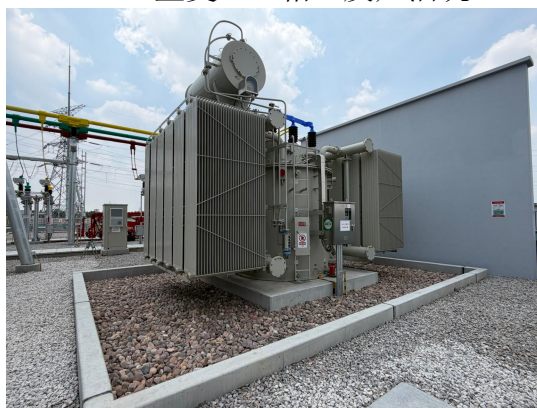
低压电抗器及贮油坑
