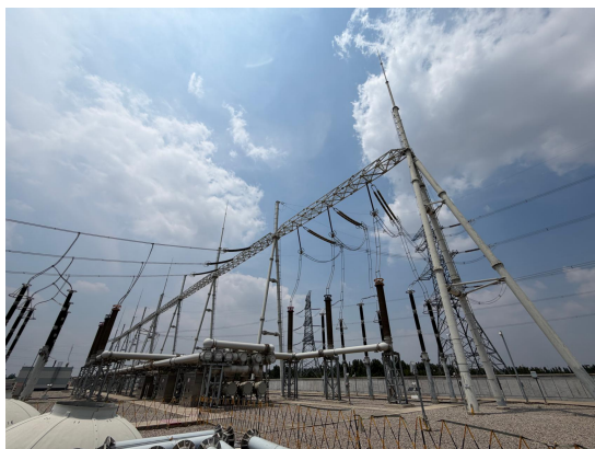
500kV 配电装置及出线
