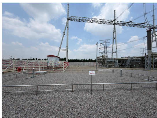
新建 2 号事故油池
