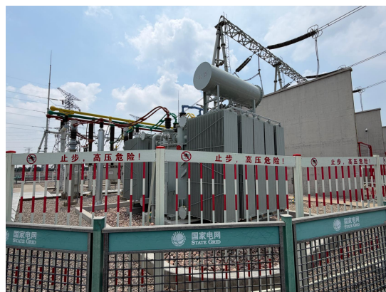
前期低压电抗器及贮油坑
