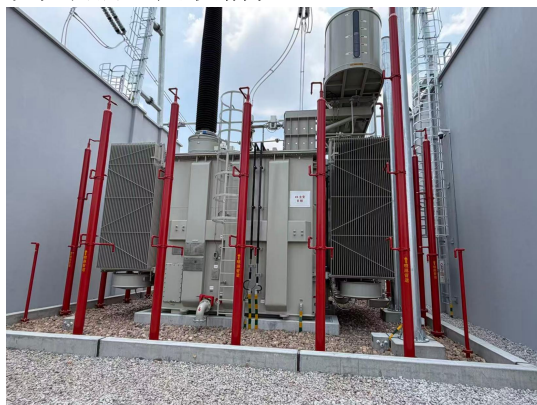
#4 主变（B 相）及贮油坑
