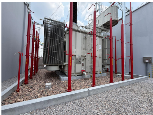
#4 主变（A 相）及贮油坑
