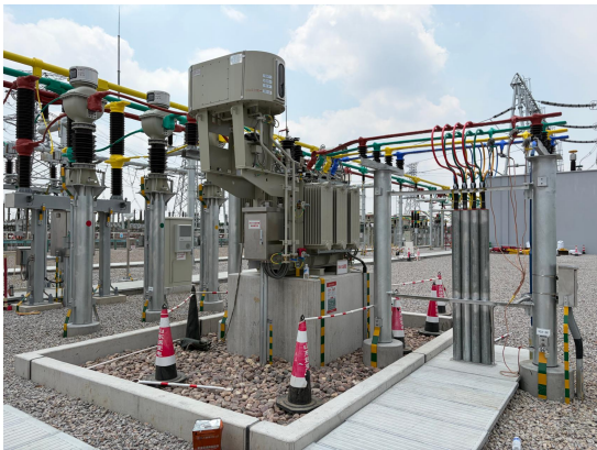
#2 站用变及贮油坑
