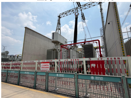
#4 主变（C 相）及贮油坑
