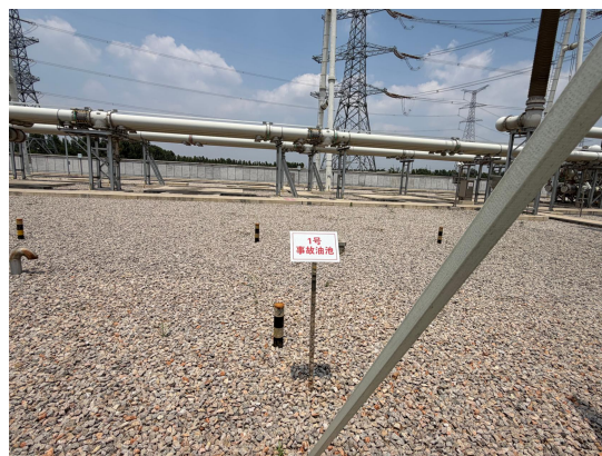
1 号事故油池（目前闲置）
