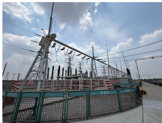
220kV 配电装置及出线
