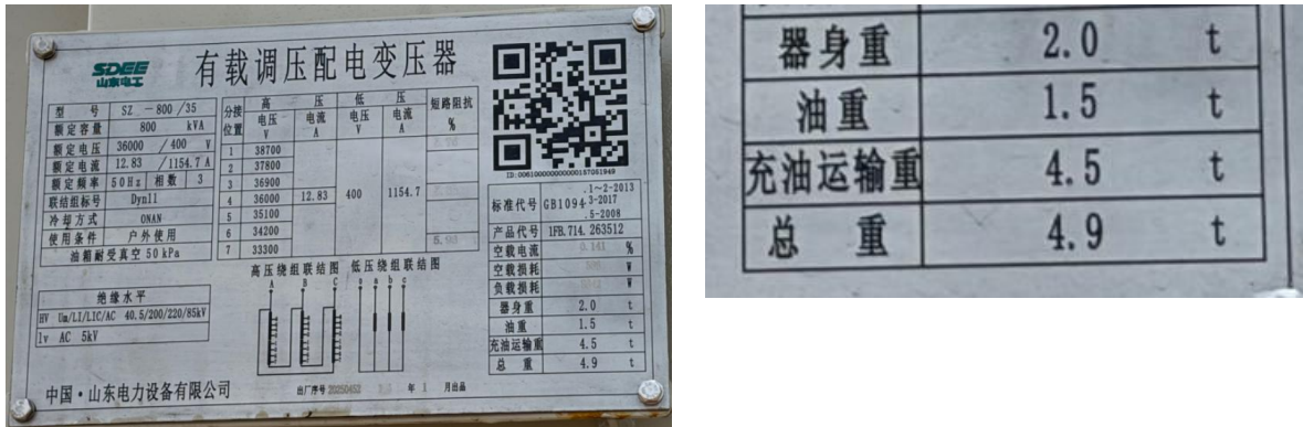
图 11.2-5 本期#2 站用变铭牌
