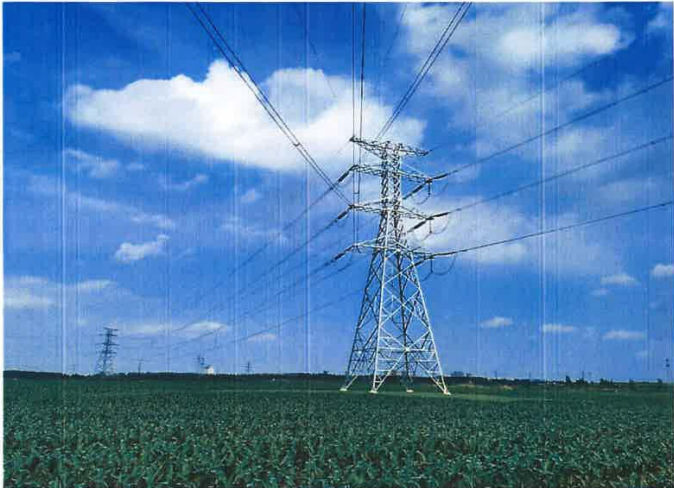
附图 3-6 项目现场照片-220kV 袁蒲线单回架空线路下方检测点位
