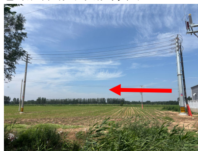
图 4-4 文昌 110kV 变电站南侧
