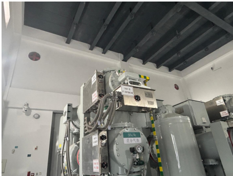
图6-5 110kV 配电室通风
