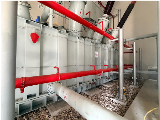
图4-7 #1主变压器（户内）
