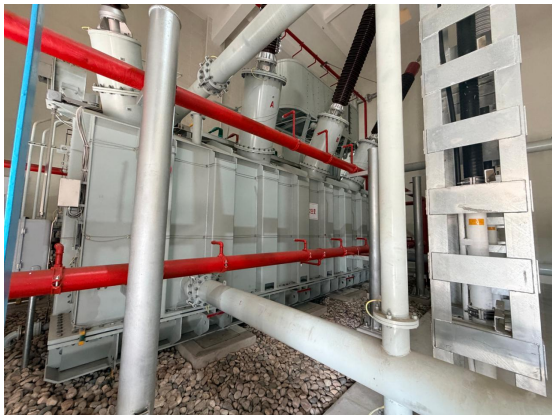
图 4-9 #2 主变压器（户内）
