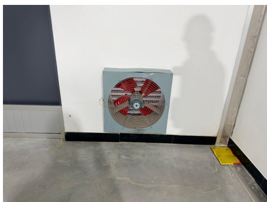
图 6-7 GIS 室内通风设施
