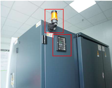
图 3-11 6 车间设备后侧工作状态指示灯及上通风口
