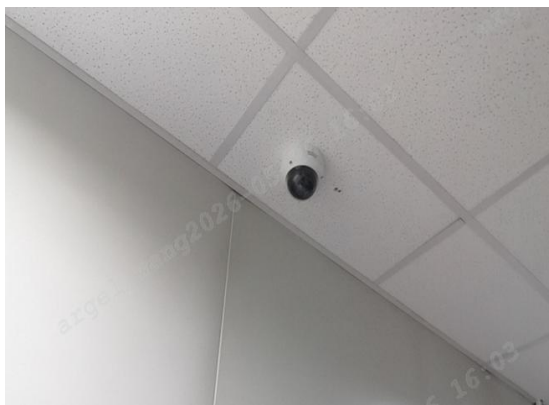
图 3-13 1 车间 CT 检测室内监控
