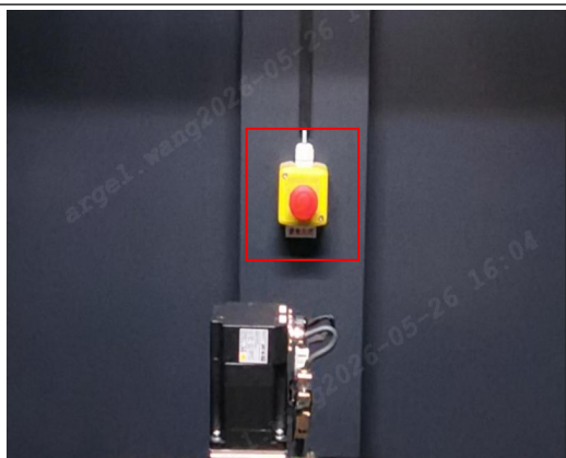
图 3-5 1 车间设备后侧检修防护门内急停按钮及标签
