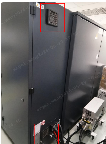
图 3-7 1 车间设备后侧通风口
