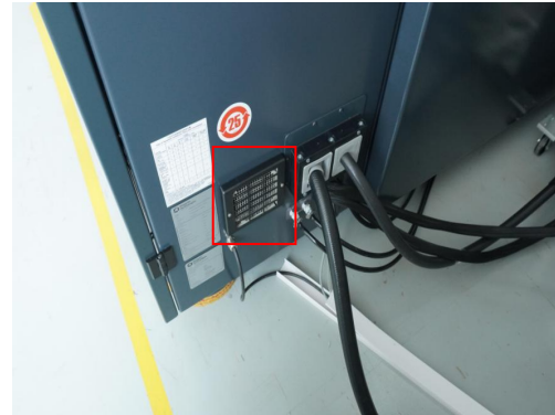
图 3-12 6 车间设备下通风口
