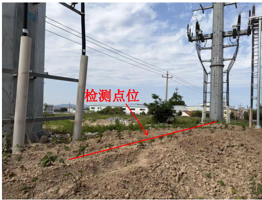
图 7-9 110kV 张城乙线新建电缆沟单回电缆线路
