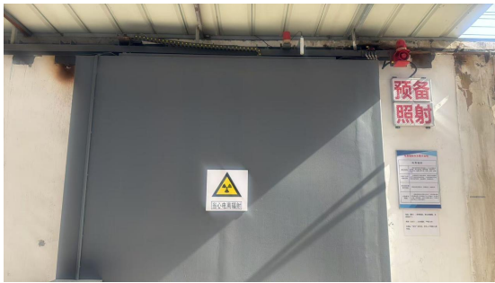
图 3-14 大防护门固定式场所辐射探测报警装置
