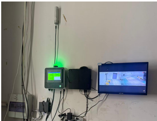
图 3-5 操作室（室内监控设备、固定式 场所辐射探测报警装置）
