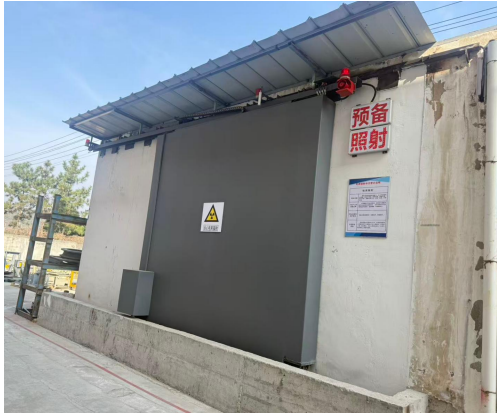
图 3-1 大防护门（工作状态指示灯、电离辐射警告标志）
