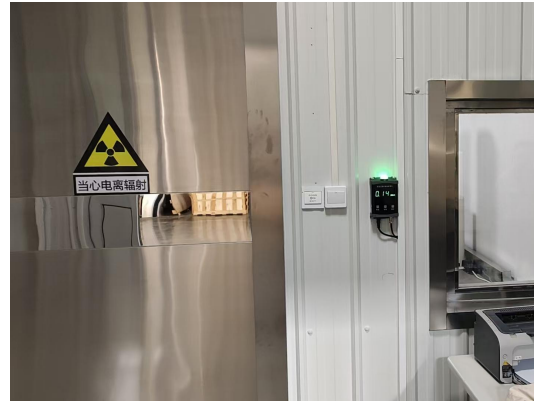
防护门上张贴电离辐射警告标志及固定式辐射剂量报警仪显示器
