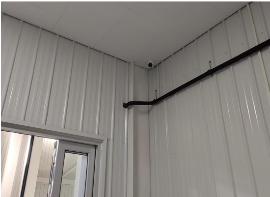
操作室内摄像头（覆盖探伤室出入口）
