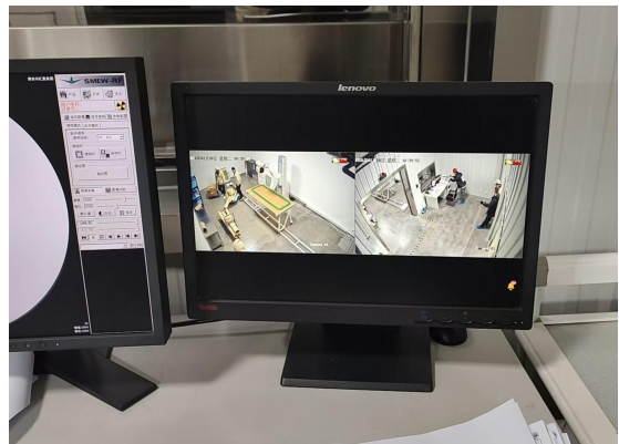
视频监控显示屏
