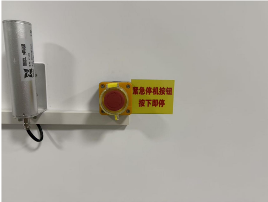
探伤室内急停按钮及固定式辐射剂量报警仪探头
