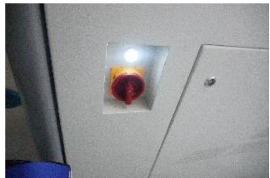
图 3-6 西侧检修防护门内急停按钮
