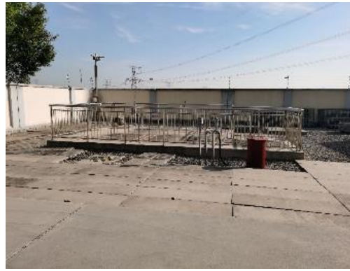
污水处理设施
