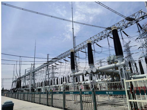
220kV 配电装置
