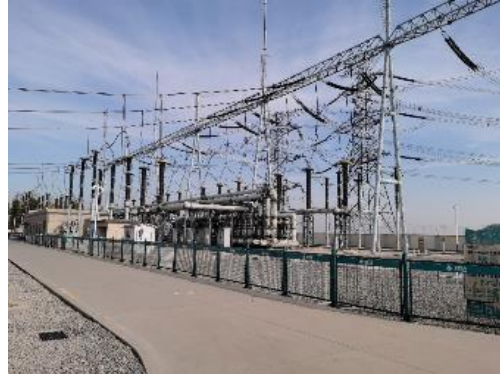
500kV 配电装置
