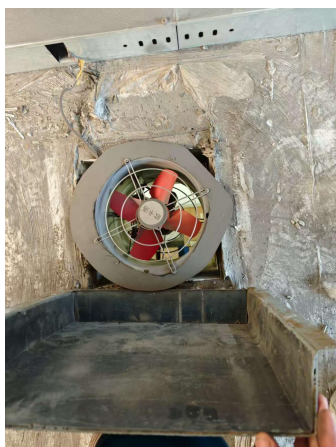
室顶通风口及排风扇
