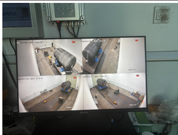
视频监控显示装置
