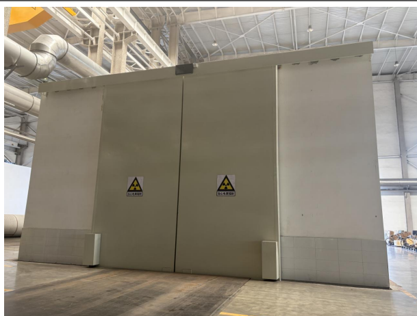
大防护门、电离辐射警告标志、工作状态指示灯
