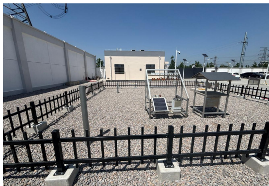
图 11.2-1 本期事故油池设施
