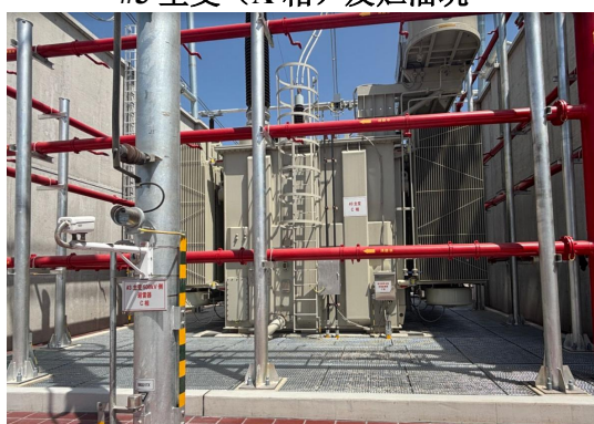
#3 主变 (C 相) 及贮油坑
