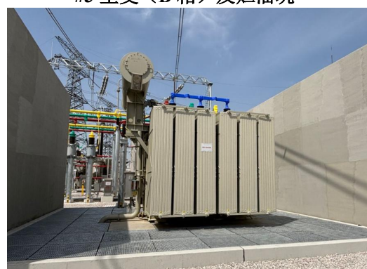
35kV 低压电抗器及贮油坑
