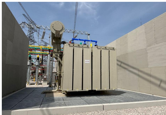
35kV 低压电抗器及贮油坑
