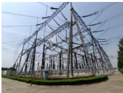
前期 500kV 配电装置
