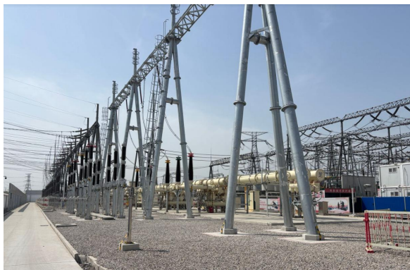
220kV 配电装置区域
