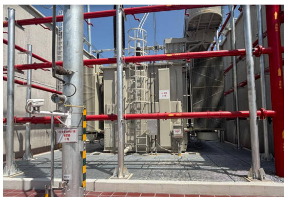
#3 主变（C 相）及贮油坑
