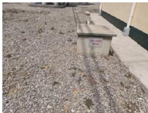
前期站用变事故油池
