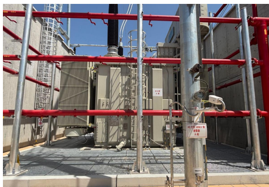
#3 主变（A 相）及贮油坑
