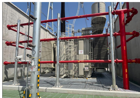
#3 主变（B 相）及贮油坑
