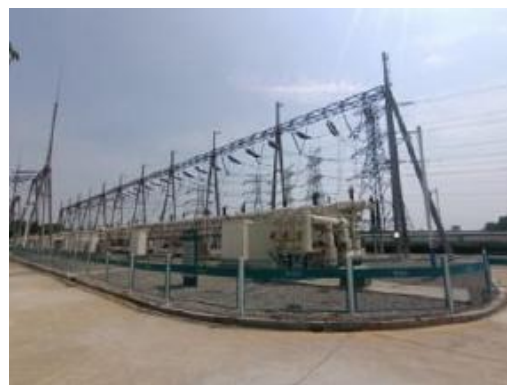
前期 220kV 配电装置
