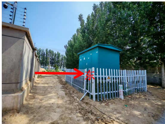
图 4-3 济宁梁山孔坊 110kV 变电站东侧
