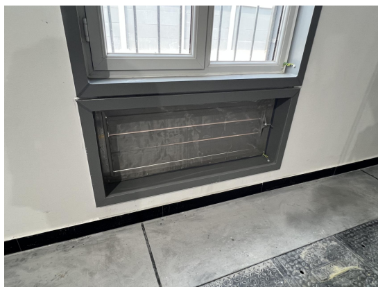
图 6-7 GIS 室内通风设施
