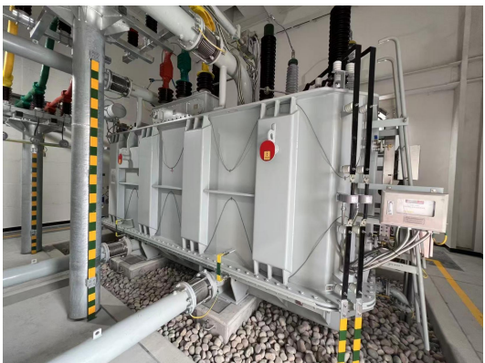
图4-8 #2主变压器（户内）
