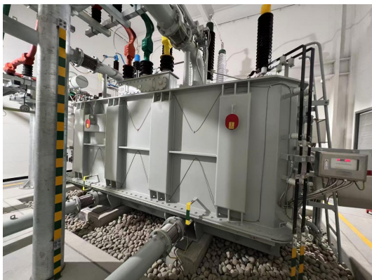
图4-7 #1主变压器（户内）
