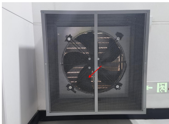
图 6-6 110kV GIS 室通风
