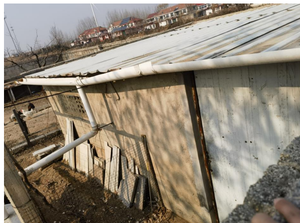
图 2-14 220kV 郁凤线 75#~76#线南 35m, 巧女张村西南侧看护房
