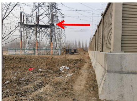
图 4-5 郁秩 220kV 变电站西侧
