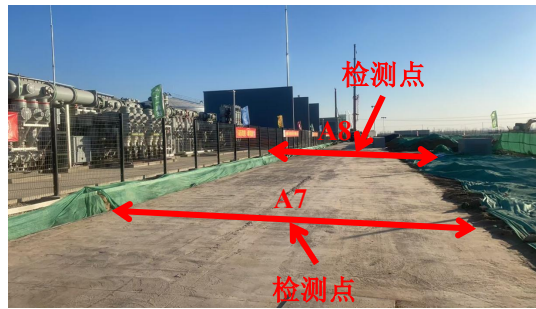
图 7-5 单回电缆线路上方检测点
