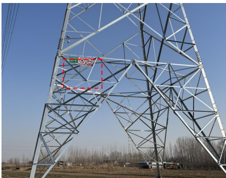
图6-2 杆塔警示防护标识
