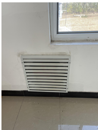
图 6-7 GIS 室内通风设施
