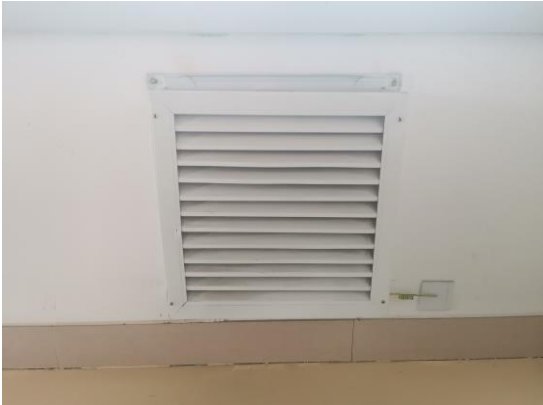
图6-4 110kV 配电装置室通风
